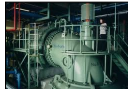
写真 8：今泉雨水ポンプ
