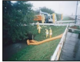
写真 10：緊急内水排除ポンプ
