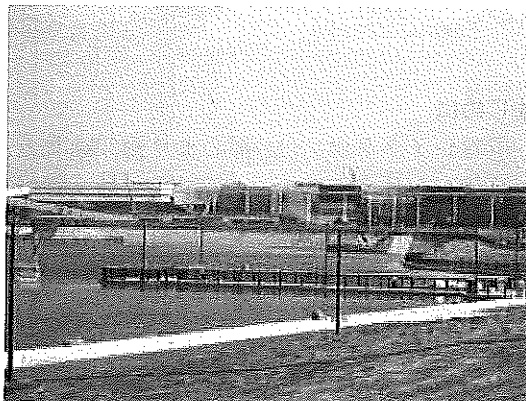
大相模調節池センターゾーンから見た複合商業施設(建設中)。今秋には、日本最大級の複合商業施設のオープンが予定されています。手前は大相模調節池に設置された栈橋で、カヌーやヨットへの乗降やイベントスペースなどとして利用できます。
