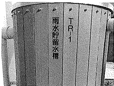
←雨水貯水タンク (500Lタンク2器)
