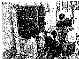
小学校へ設置した雨水タンク一例
